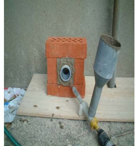
EFTERLAGA KRING RÖR
